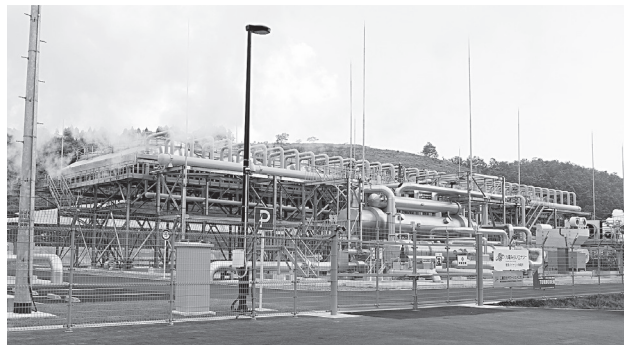
▲菅原バイナリー発電所
